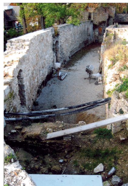
Schkölen, Saale-Holzland-Kreis. Zwinger der Westseite: Diskrepanz zwischen Ergänzung (links) und Verfall (rechts) zweier Mauerzüge (Foto: Verf., Okt. 2006).
